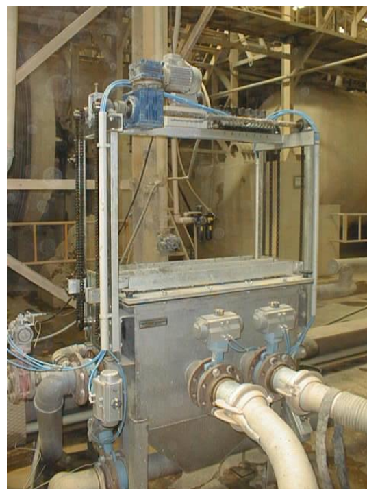
CVA.40.570.N10500 em funcionamento
